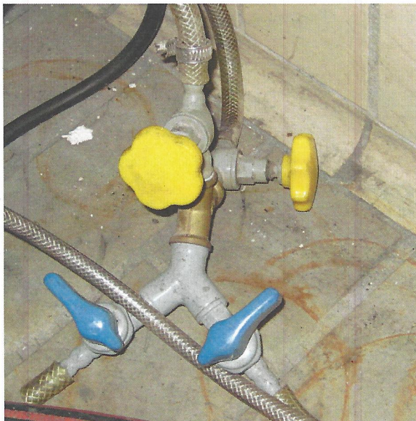
Ventile für die Vakuumpumpe Die Pumpe wird auch zum Evakuieren der Foliengießmasse benötigt, daher werden einige Umschaltarmaturen benötigt.
